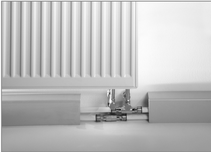
Heizkörperanschluss aus der Sockelleiste
