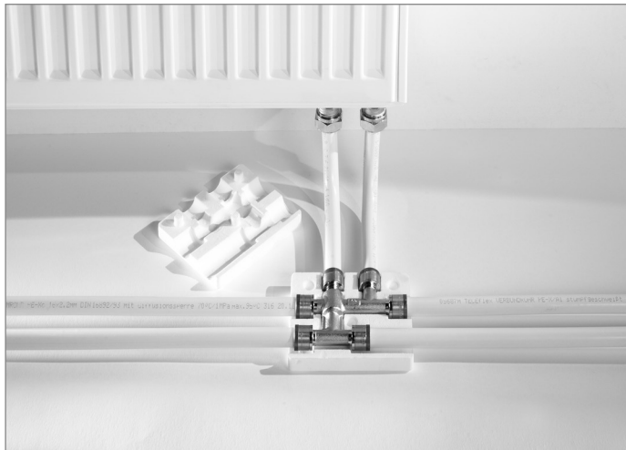
Heizkörperanschluss mit Kreuzungsfitting
