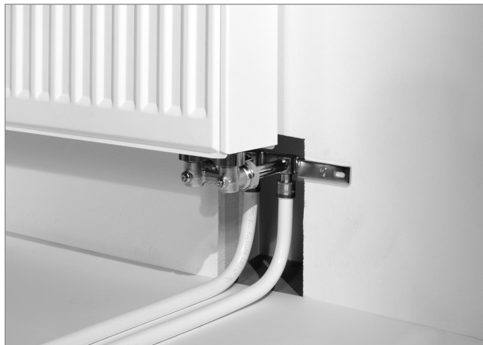
Heizkörperanschluss mit HK-Montagegarnitur – an den Hahnblock angeschlossen
