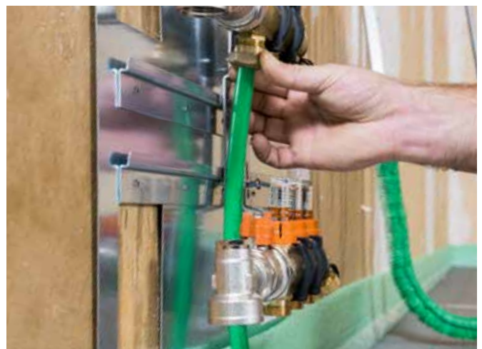
Anschluss der Fußbodenheizungsrohre an den Verteiler, Befüllung der Anlage mit Wasser und Dichtheitsprüfung.
