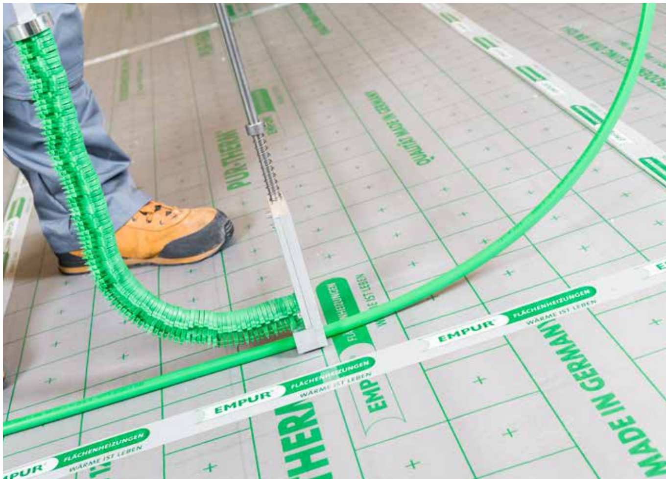
Einbringen der KLIMAPEX® Heizrohre anhand des aufgedruckten Verlegerasters mit PUR-THERM® Tackernadeln und dem Systemtacker.
