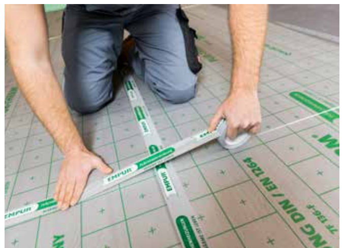
Verlegung der EMPUR® Verbundplatten. Der einseitige Folienüberstand überlappt auf die Anschlussplatte und verhindert ein Eindringen des Estrichs.
